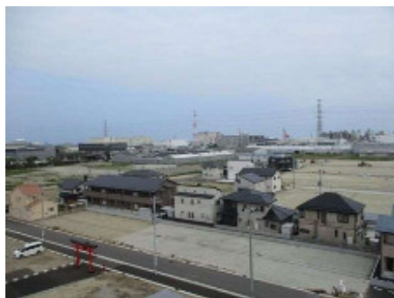
▲造成工事の様子(平成29年6月) (災害公営住宅から南東方角を撮影)
